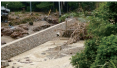
平成25年の島根県及び山口県の大雨の被災現場 (島根県津和野町提供)
